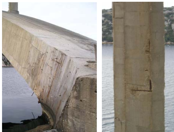
Slika 2. Oštećenja luka u peti i oštećenja stupa
